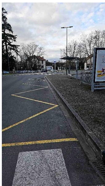
Arrêt avec un quai insuffisamment réhaussé
