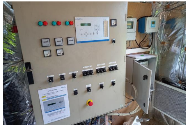
Armoire électrique dans local technique
