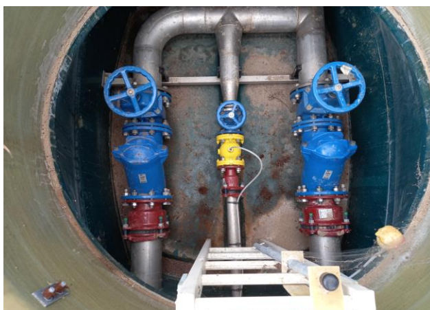
Chambre des vannes
