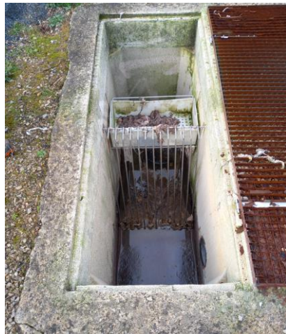
Dégrilleur manuel et bypass
