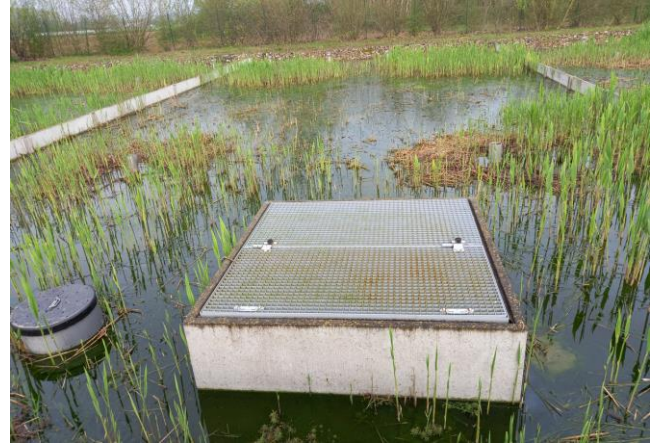
Regard de répartition
