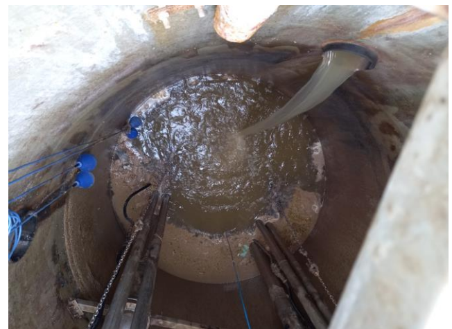
Poste de refoulement avec arrivée effluents bruts et recyclés
