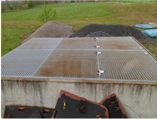
Chambre débitmètre + refoulements
