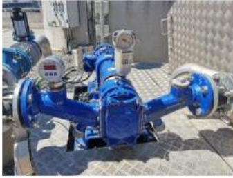
Pompe d'extraction des flottants de la fosse jusqu'au local boues
