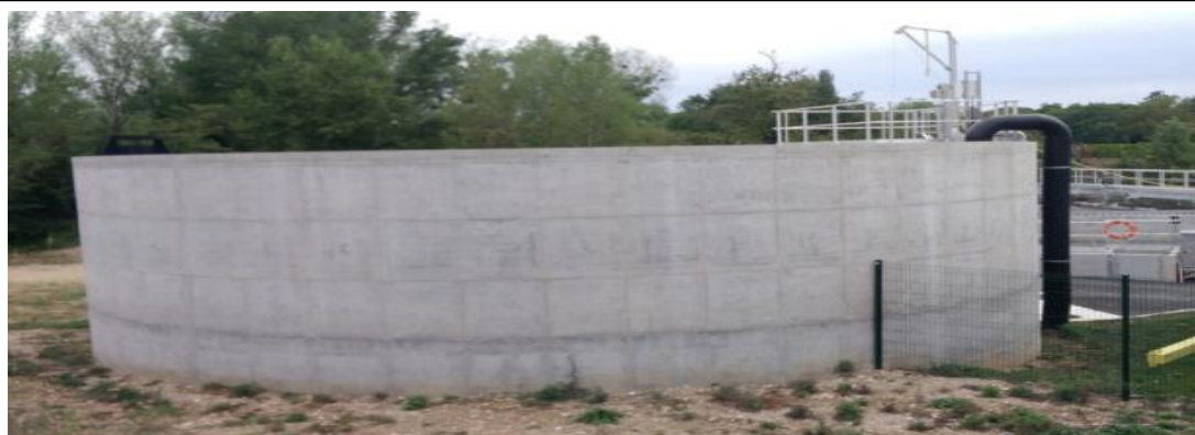
Extraction des boues – Epaissement sur table d'égouttage – Silo de Stockage pour épandage
