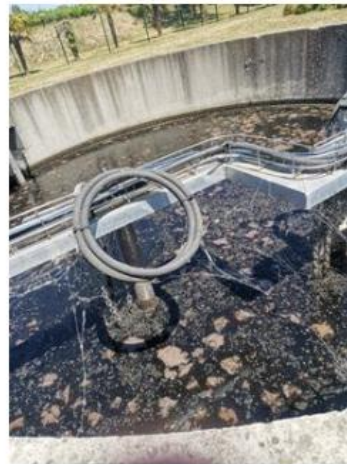
Poste de recirculation et sonde de niveau
