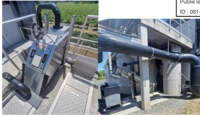
Dégrilleur escalier EMO avec 2 points de désodorisation (à gauche) et compacteur (à droite)
