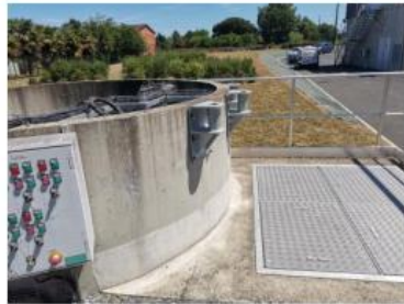
Vue d'ensemble du poste de recirculation – armoire électrique et CV à droite sous la trappe
