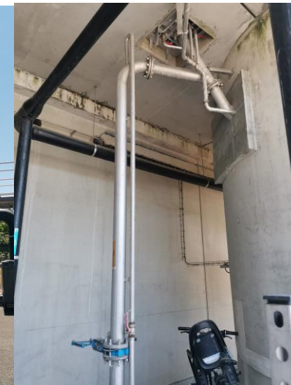
Système de récupération des sables par air lift
