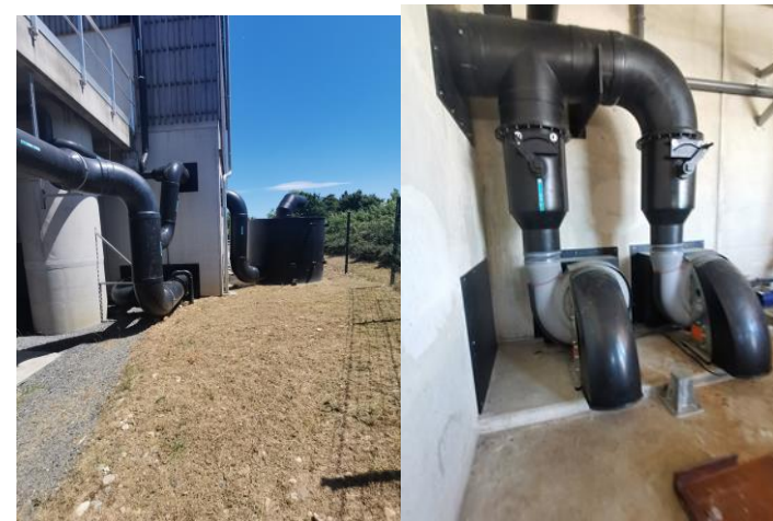
Système de désodorisation – à gauche, filtre à charbon actif, à droite, aspiratio d'air dans local technique
