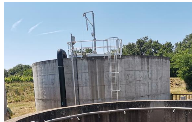
Silo de stockage des boues
