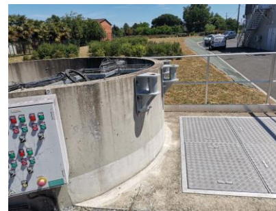
Vue d'ensemble du poste de recirculation – armoire électrique et CV à droite sous la trappe
