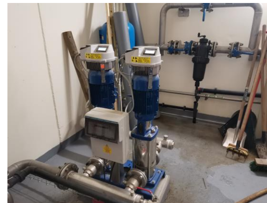
Au fond, filtre à particules, à l'avant, pompe d'alimentation en eau industrielle
