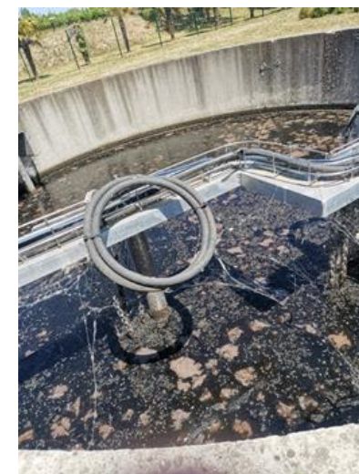
Poste de recirculation et sonde de niveau
