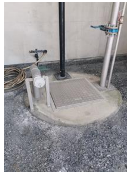
Fosse de stockage, accès et vidange
