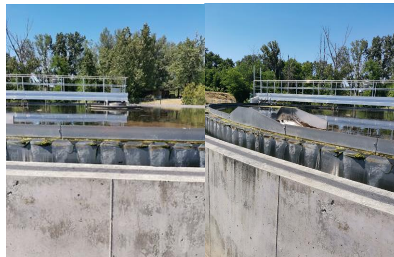
Vue d'ensemble du clarificateur – goulotte de débordement – pont racleur – saut à ski
