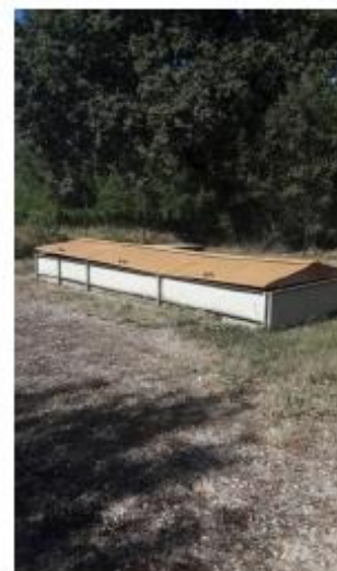
Disques biologiques + clarificateur lamellaire
