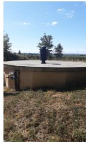
Décanteur/digesteur avec dégraisseur
