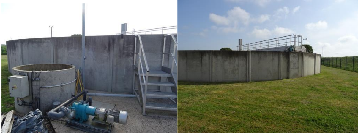
Le Puit à flottant avec pompes d'extraction et vue générale du bassin
