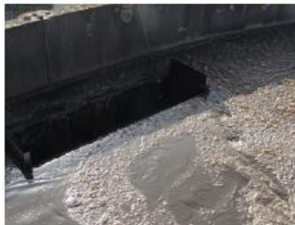
Sortie des effluents du bassin (problème d'obturation)
