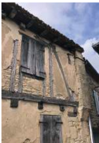
Des pans de bois avec des traces d'enduit ancien
