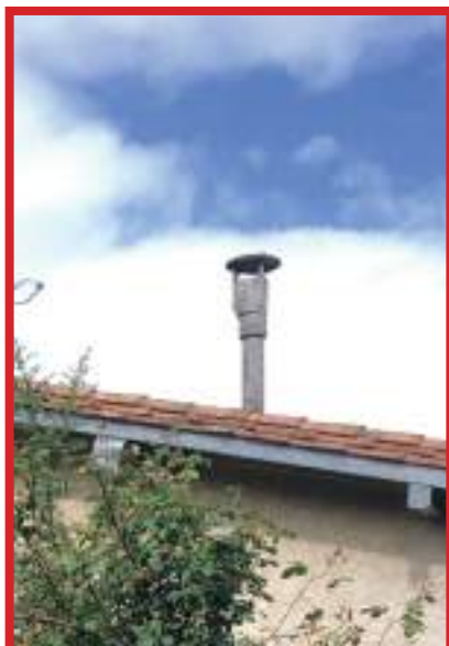
Conduit de cheminée à éviter
