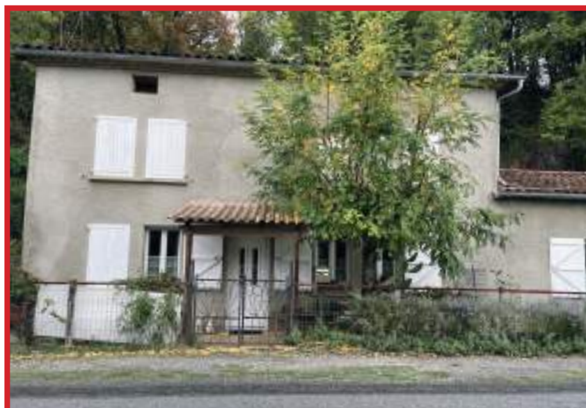
Une ancienne ferme mise à mal par la pose d'un enduit ciment, la matérialité des menuiseries, etc.
