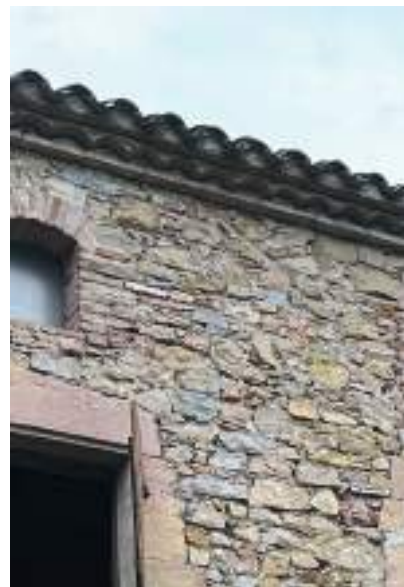
Cheminées avec enduit ciment : à éviter
