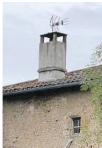
Cheminées avec enduit ciment : à éviter
