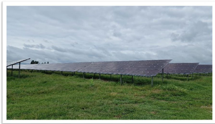
Centrale photovoltaïque du Mas de Rest
