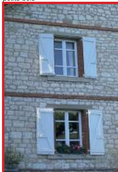
Le modèle de menuiserie mis en œuvre ici n'est pas bonne. La division des carreaux n'est pas correct
