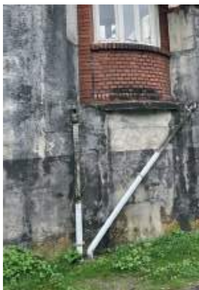
Gouttières PVC : à éviter
