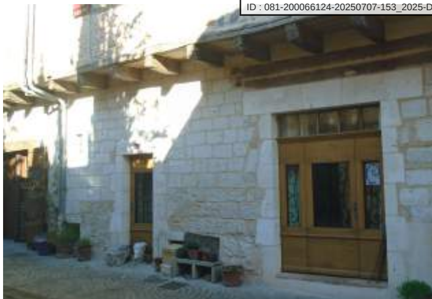
Maçonnerie en pierre de taille à restaurer
