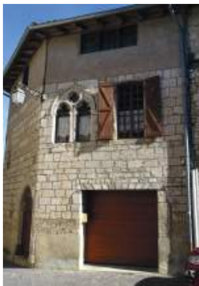
Maçonnerie en pierre de taille mais joints ciments : à éviter
