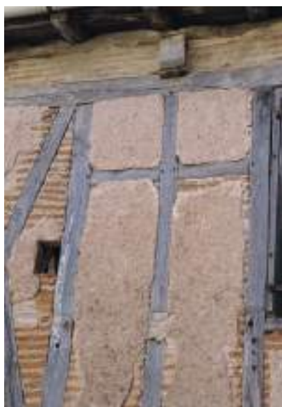
Pan de bois avec des traces d'enduit ancien : à préserver et restaurer
