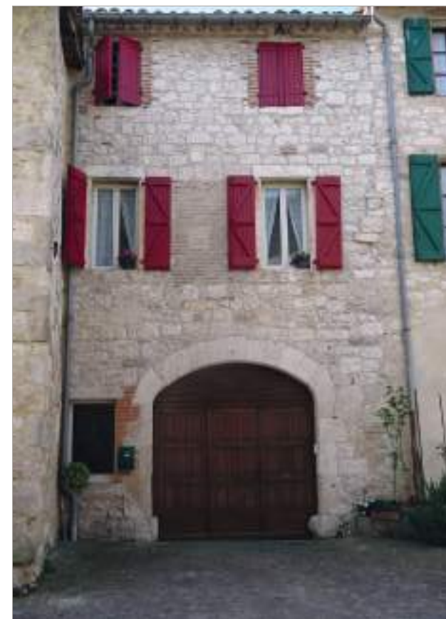
Parcelle 255 - Place de l'Eglise - La suppression de l'enduit laisse voir une maçonnerie constituée de moellons de différentes tailles.
