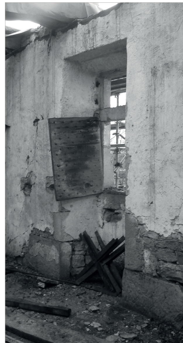
Vestige d'un volet à lames croisées - Grange de Bargues, Assier, Lot.
