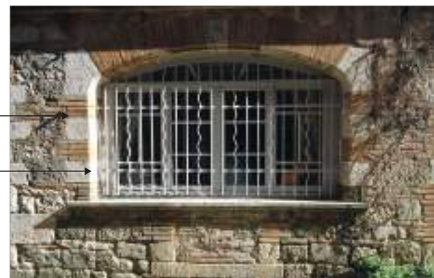
La baie de la boutique aujourd'hui partiellement murée.
