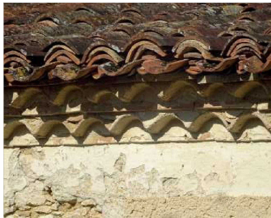
Génoise badigeonnée en blanc. Le premier rang de tuile est également en débord pour protéger la génoise.
