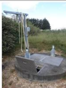
Poste de relevage
