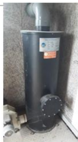
Filtre à charbon actif du PR
