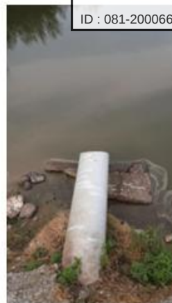
Canalisation de liaison entre les bassins
