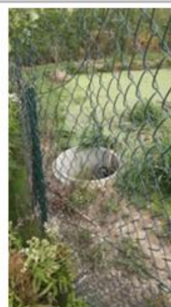
Tuyau de mise en charge
