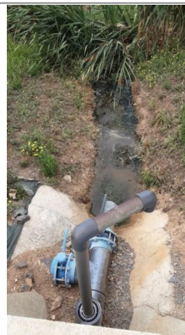
Trop plein et vannes permettant de choisir le rejet direct après le filtre ou passage par ZRV
