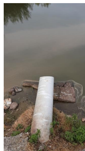
Canalisation de liaison entre les bassins
