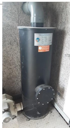
Filtre à charbon actif du PR
