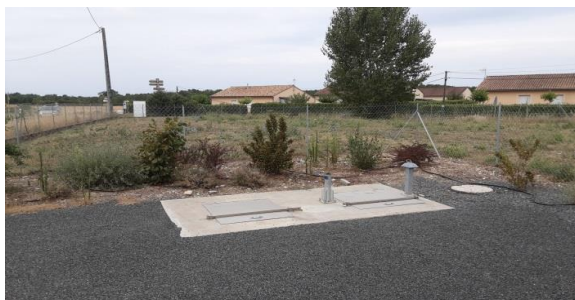
Poste de relevage
