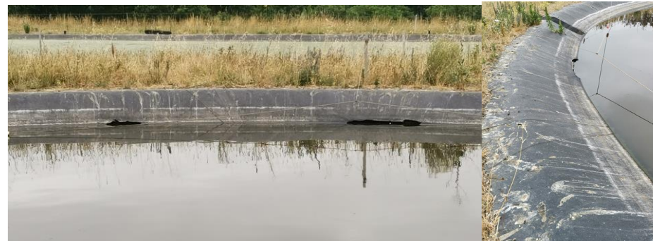
Percements de la lagune aérée n°1 (construction - 2005)
