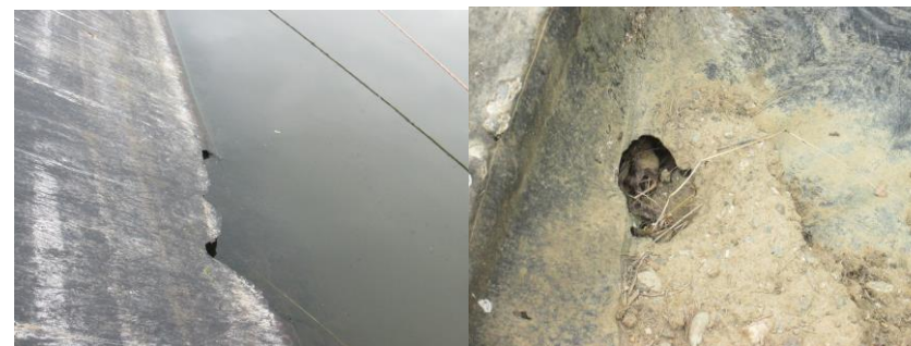
Percements de la lagune aérée n°1 – sur la bassin (à gauche) – au niveau de la chambre de dégraissage (à droite)
