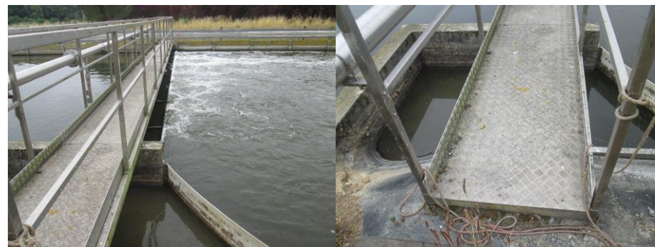
Lagune aérée n°1 Pont d'accès aux rampes d'aération (à gauche) Chambre de tranquillisation et de récupération des graisses (à droite)
