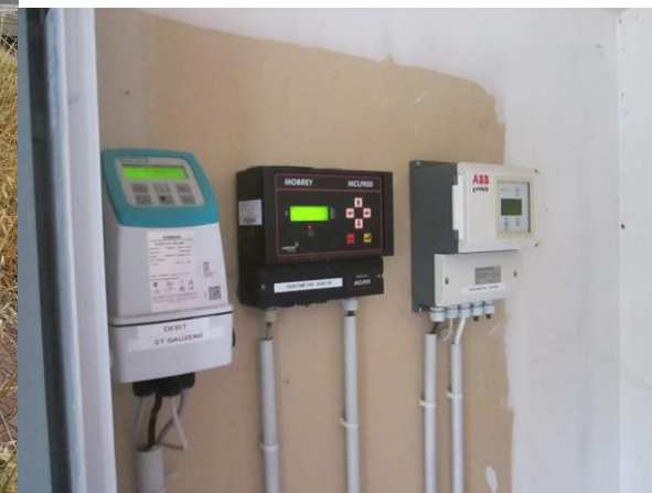
Regard d'accès aux deux conduites d'arrivée et moniteurs des débitmètres
