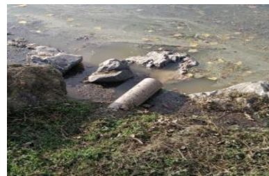
Décanteur vers lagune n°1
