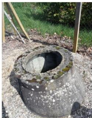
Regard à l'entrée de la station
