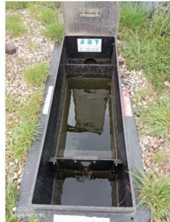
Canal de comptage de sortie
