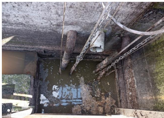
Poste de relevage
