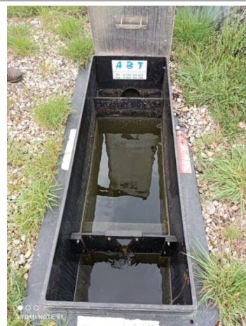
Canal de comptage de sortie
