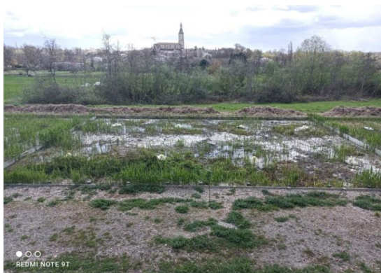
Lit plantés de roseaux - Le lit semble noyé
