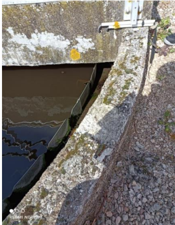
Structure bétonnée vieillissante
