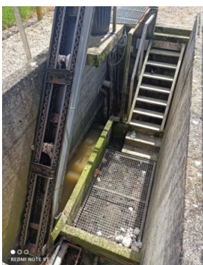
Dégrilleur automatique incliné et DO tête de station
