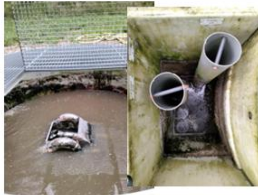
Ouvrage de bâchée et répartition 1er étage
