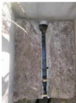
Canal débitmétrique d'entrée
