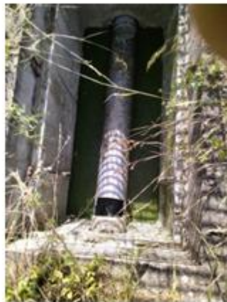
Conduite assurant la liaison hydraulique
