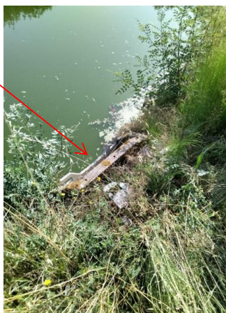
Planche amovible permettant de gérer le passage de l'eau d'un bassin à l'autre
