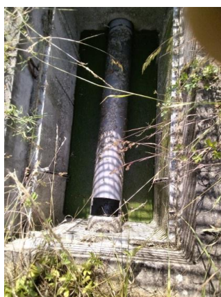
Conduite assurant la liaison hydraulique
