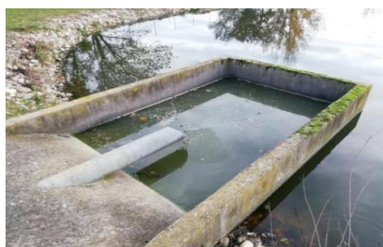
Arrivée des eaux dans le premier bassin
