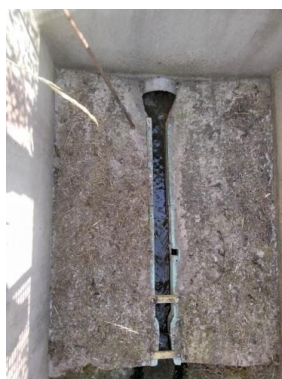
Canal débitmétrique d'entrée
