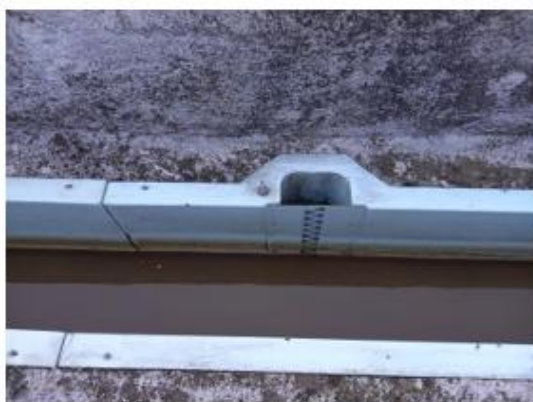
Canal de comptage entrée - Absence de caillebotis - Techniflow 94 FI 010
