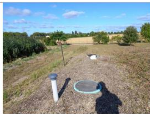
Ouvrage de bâchée 2nd étage (rectangulaire 5x1 m)
