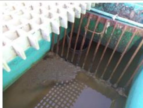
Dégrillage manuel avec caillebotis - Refus vers OM
