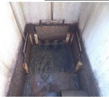
Ouvrage de répartition 3 lits - Vannes guillotines alternance manuelle
