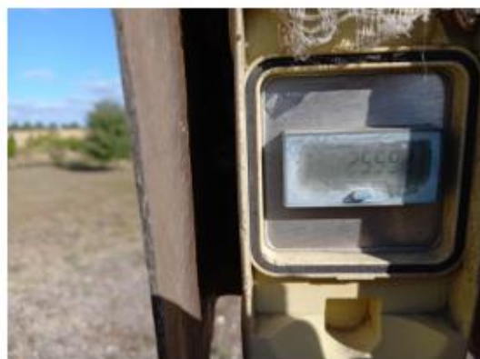
Compteurs de bâchées (x2)
