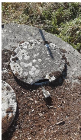
Bouche du décanteur digesteur cassée
