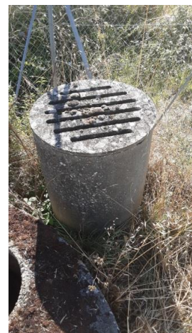
Regard de visite de sortie
