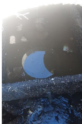
Déchets dans le bac de tranquillisation du lit bactérien
