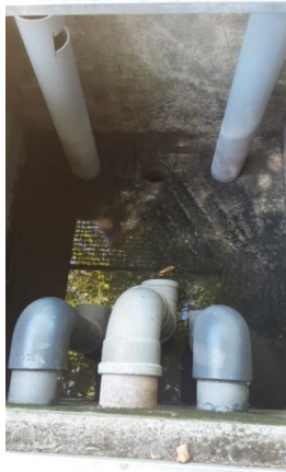
Ouvrage de répartition
