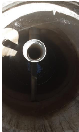
Regard de visite avec dispositif de mise en charge
