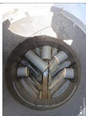
Regard de collecte des drains
