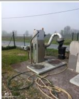
Poste de relevage et dégrillage + ensacheur
