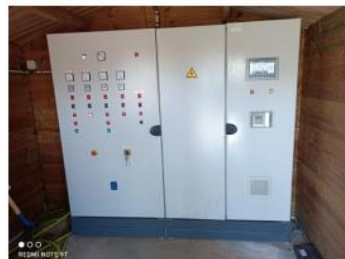
Armoire électrique dans local technique
