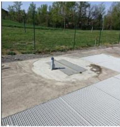
PR d'alimentation n°1 + chambre de vanne avec caillebotis
