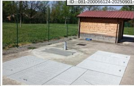
PR d'alimentation n°2 + chambre de vannes
