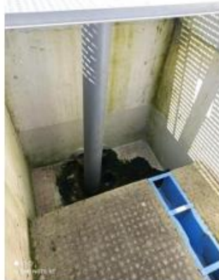
Canal de comptage venturi
