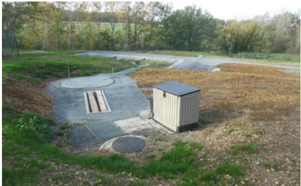
By-pass + dégrilleur manuel + canal de comptage
