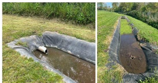
Entrée et sortie du fossé filtrant
