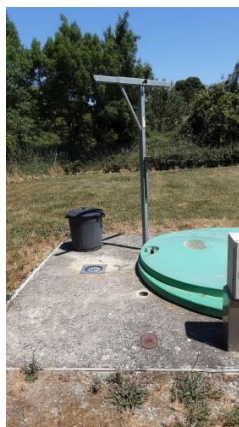
Poste de relevage
