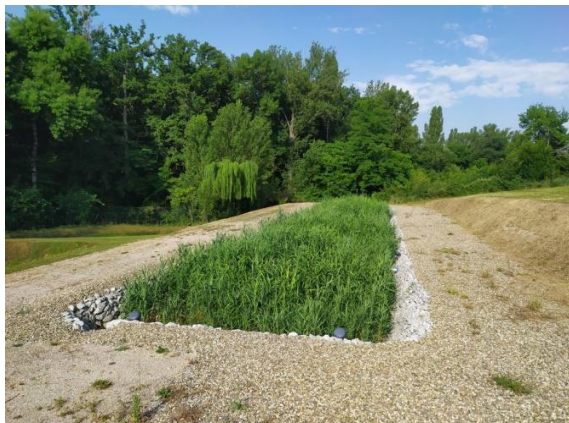
Filtre planté de roseaux (1 étage)
