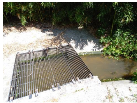
Sortie canal de sortie amont ZRV - Eau trouble
