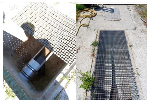
Déversoir d'orage et canal de comptage
