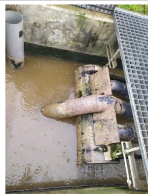
Chasse hydraulique à auget
