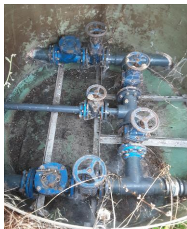
Chambre des vannes du PR n°2
