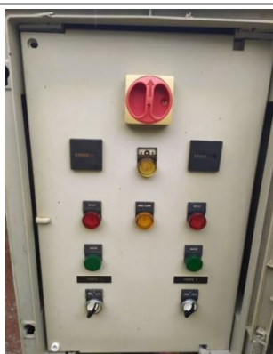
Armoire électrique du PR
