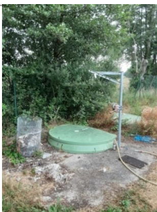
Poste de relevage 1
