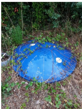
Chambre à vannes recouvertes de ronces
