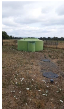
Filtre bactérien et clarificateur
