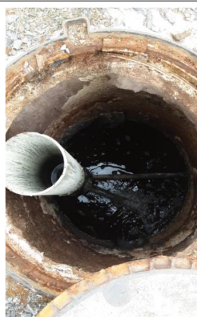
Regard avec arrivée du trop plein et de la canalisation de sortie des lits
