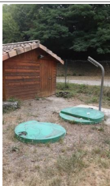
Local technique et poste de relevage
