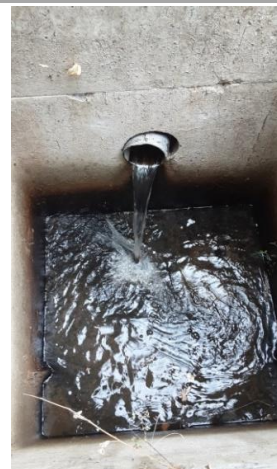
Eaux sortant de la zone de rejet végétalisée
