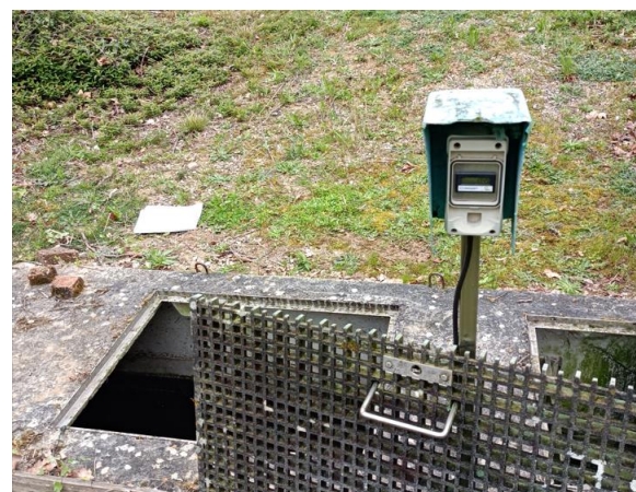
Compteur de bâchée
