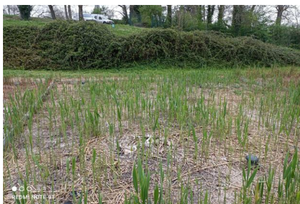
Filtre planté de roseaux - 3 lits - 1er étage
