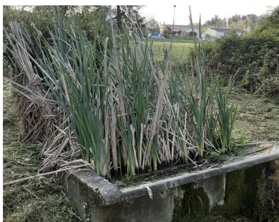
Rejet dans casier béton avec roseaux (fuyard)
