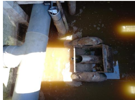
Ouvrage de bâchée - et compteur de bâchée mécanique
