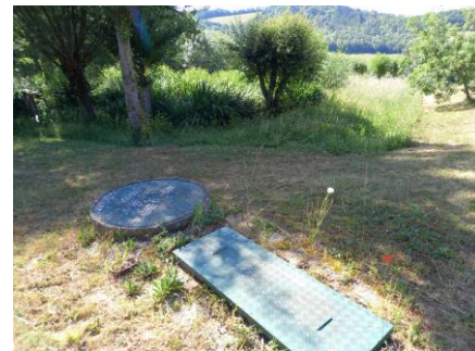
Canal de sortie et alimentation ZRV
