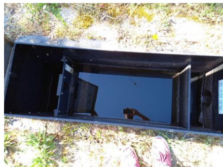
Canal de sortie
