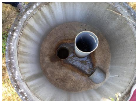
By-pass bassin 1 et 2 de la ZRV
