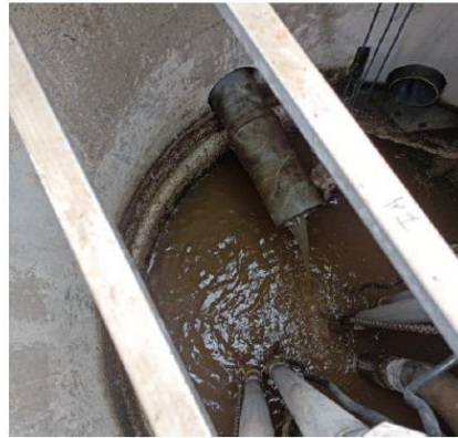
PR 1 avec comptage trop-plein - traces de déversements
