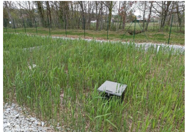
Regards de mise en charge
