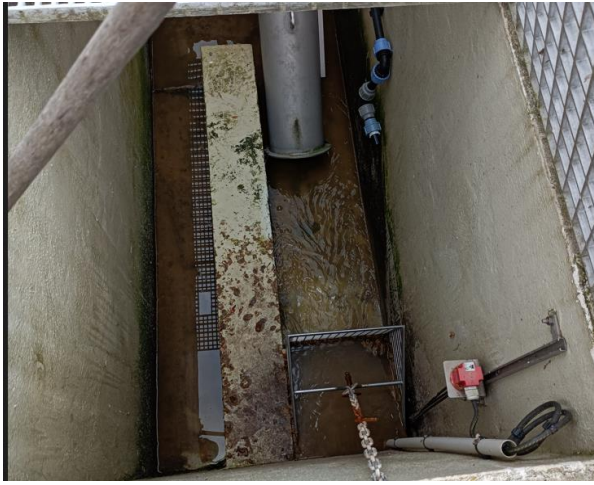
Dégrilleur manuel de secours
