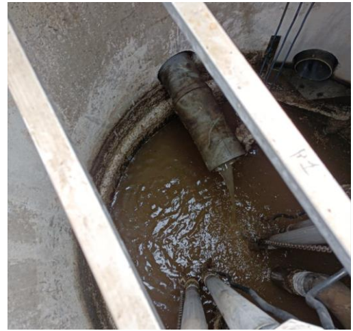
PR 1 avec comptage trop-plein - traces de déversements
