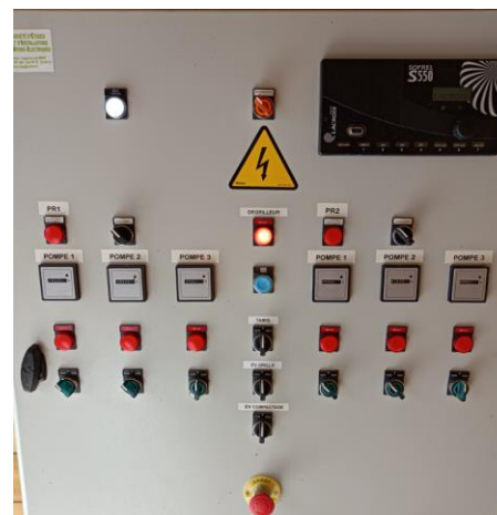
Armoire électrique dans local technique
