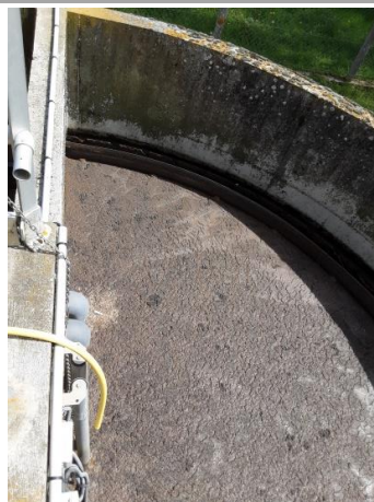
Clarificateur semi-circulaire - Présence d'une croute de boue en surface
