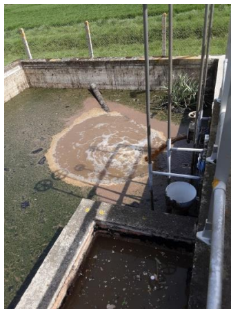
Bassin boue activé
