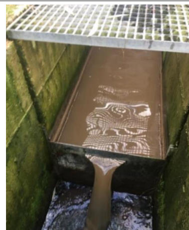
Canal de sortie avec seuil en V
