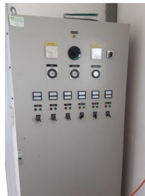
Intérieur local - Armoire électrique
