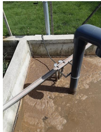
Boue activée - Turbine remplacée par hydroéjecteur
