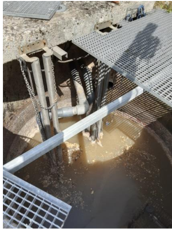
Poste de relevage
