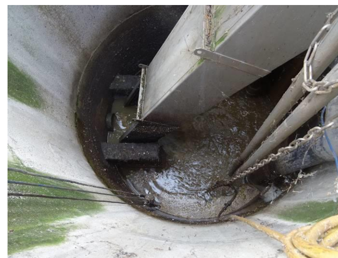
Poste de relevage et dégrilleur sur l'arrivée
