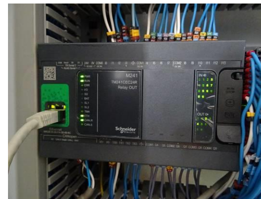
Automate dans l'armoire électrique
