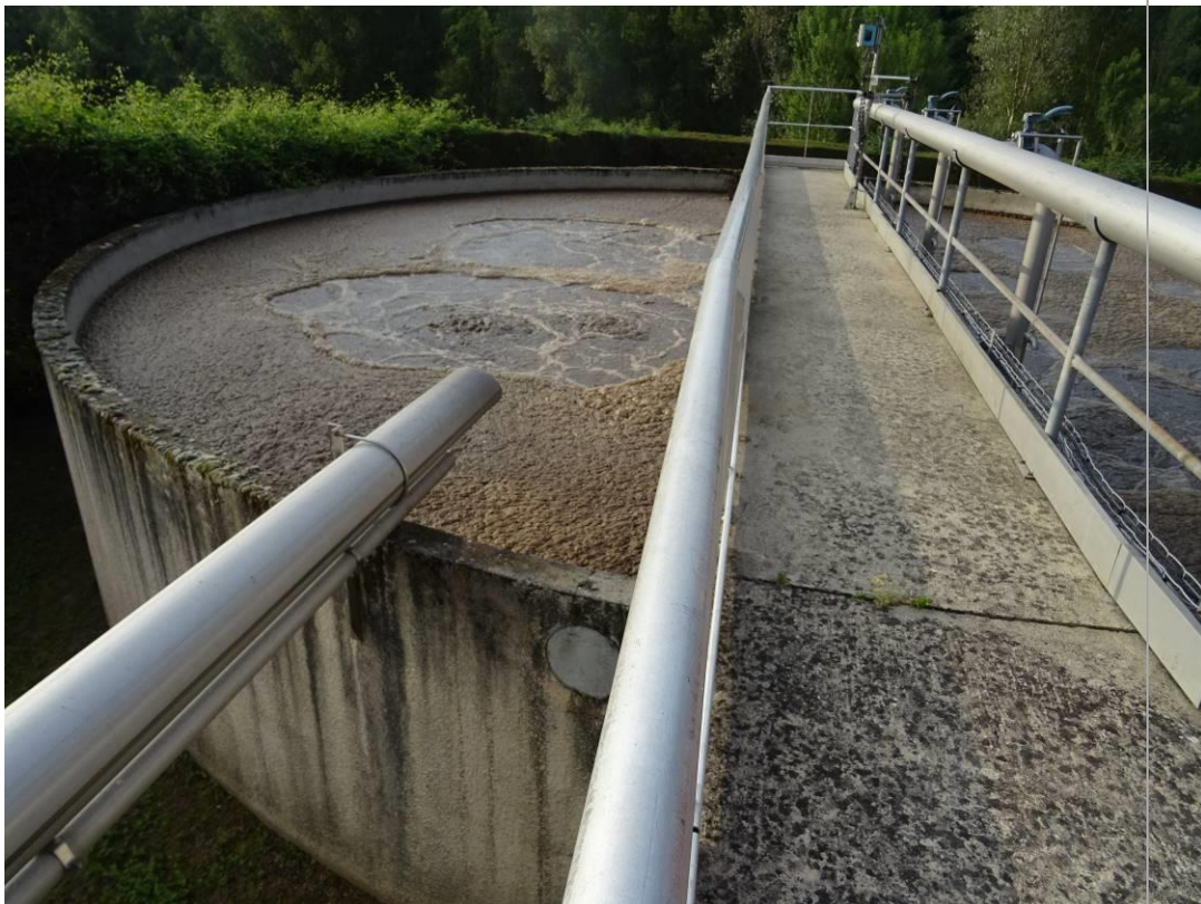
Vue d'ensemble du bassin d'aération
