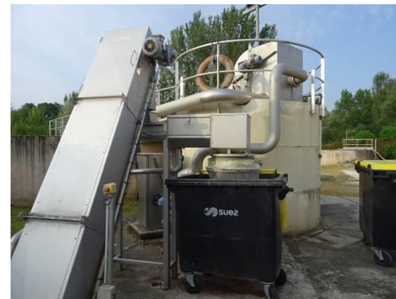
Dégrilleur automatique et compacteur
