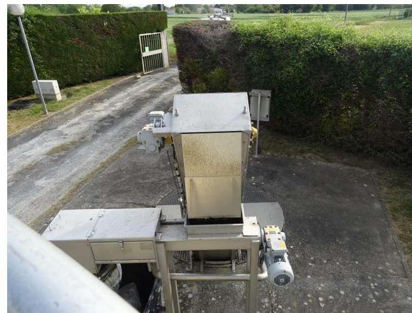
Arrivée des effluents sur la station – by-pass et poste de relevage au pied du dégrilleur
