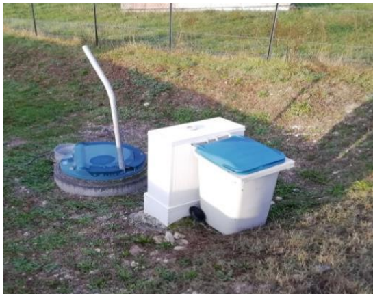
Poste de relèvement
